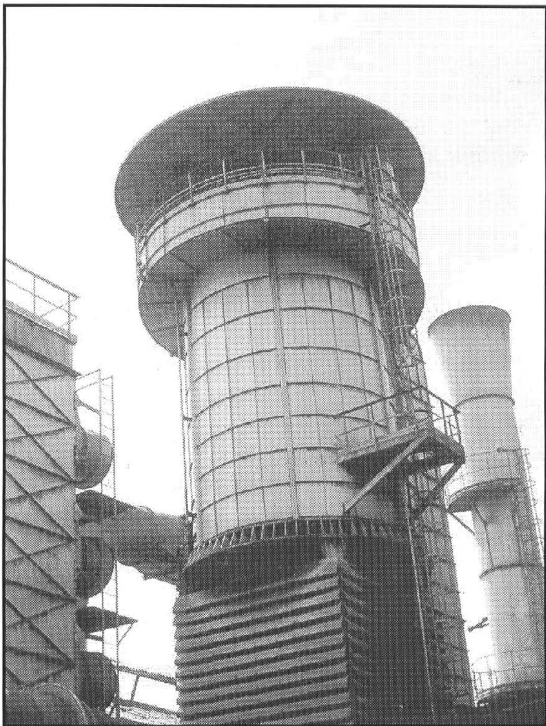
รูปที่ 8 ลักษณะของปล่องปล่อยสู่อากาศของเตาหลอม และระบบกำจัดฝุ่น (Dust Collector)
