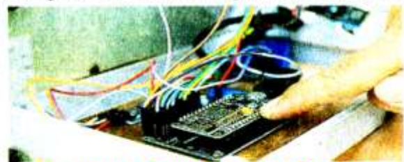
แผงควบคุมและสวิตช์ ระบบเปิด-ปิดน้ำอัตโนมัติ.
