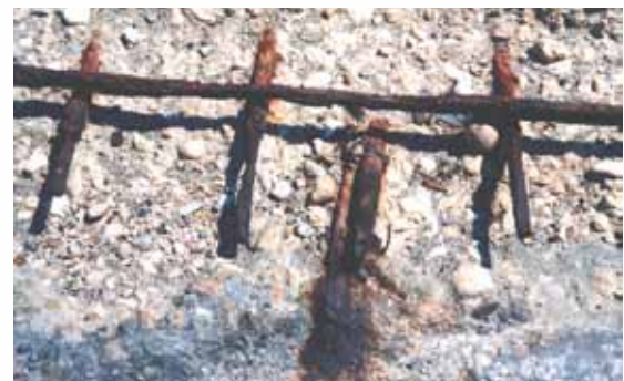
ภาพที่ ๒ ความเสียหายของคอนกรีตเสริมเหล็กเนื่องจากคลอไรด์
