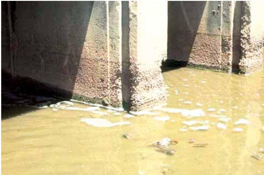
ภาพที่ ๓ ความเสียหายของคอนกรีตเนื่องจากซัลเฟต
