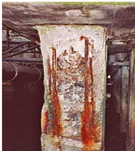
ภาพที่ 2 ความเสียหายของเสาคอนกรีตเสริมเหล็ก เนื่องจากการเกิดสนิมของเหล็กเสริม
