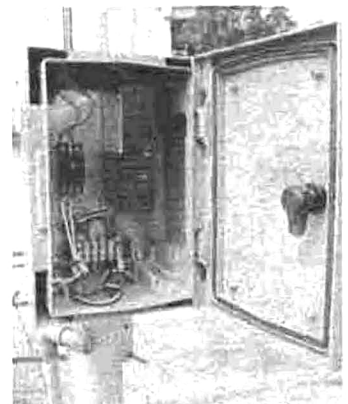
ชุดควบคุม
